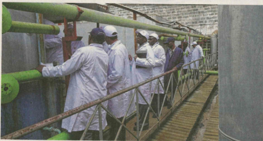
Auch durch Kenia pirschten Fachleute der „Energy Consulting Allgäu“, um Energie-Lecks aufzuspüren. Genauer gesagt: um einheimische Fachleute auszubilden, die das von der Regierung gestartete Energiespar-Programm umsetzen. In einer Molkerei in Nairobi war man zwischen Tanks und Kühlanlagen unterwegs. Foto: oh
